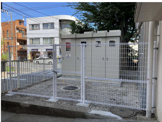
屋外受変電設備
